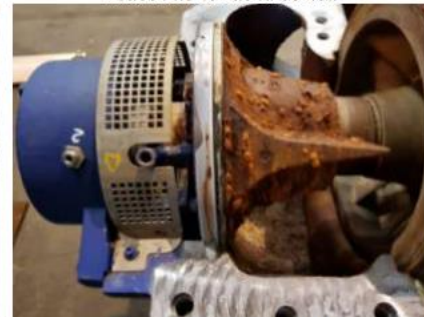
Lado contrario acoplamiento
