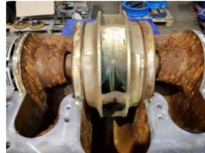
Lodos interior de la bomba
