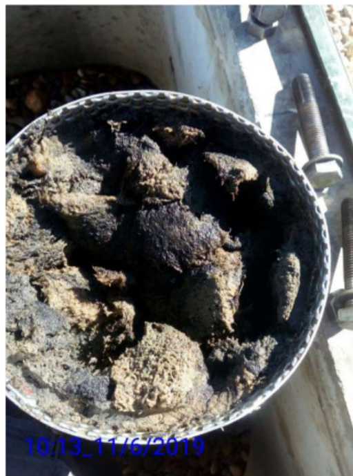
Filtro cazapiedras Sector III – año 2019
